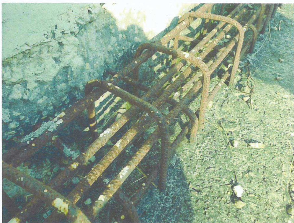
Figura 133 - Situação da armadura exposta
